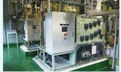
2F/脱水機 し尿等に薬品を加えて凝集させ、多重円板形脱水機により固液分離・脱水します。
