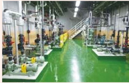
B1F/ポンプ室 ポンプを地下に集約し、一括管理しています。
