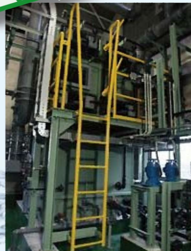
2F/生物脱臭塔 水槽・機器等から発生する高濃度臭気を、微生物の働きによって分解処理します。
