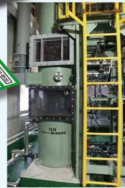
2F/アルカリ・酸化剤洗浄塔 生物脱臭処理後の臭気を、薬品を使って分解処理します。
