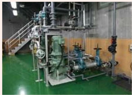
B1F/破碎機 し尿等の中に含まれる夾雑物を破碎し、ドラムスクリーンへ移送します。
