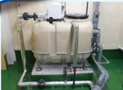
2F/雨水貯留槽 屋根に降り注ぐ雨水を集め、貯留します。貯留した雨水はトイレの流し水として使用します。
