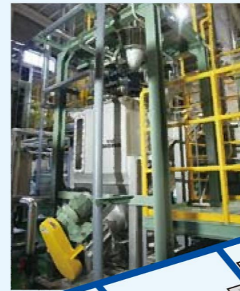
2F/細砂除去・洗浄装置 夾雑物除去後のし尿等から細砂を分離、洗浄します。
