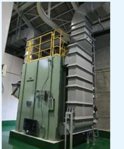
2F/活性炭吸着塔 活性炭を使って、残ったわずかな臭気を取り除きます。
