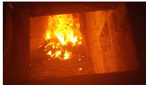
H30年11月 ごみ焼却状況
